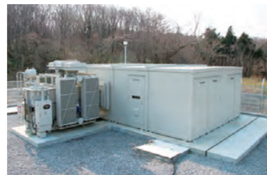
14 受変電設備用
