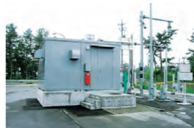
15 高速道路用 (スマートIC管理施設)
